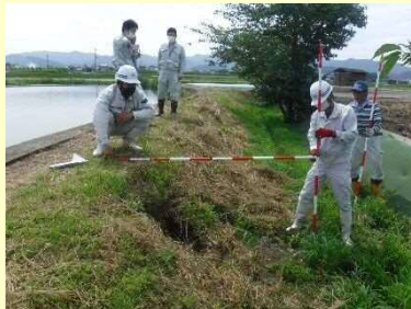
堤体陥没の確認
