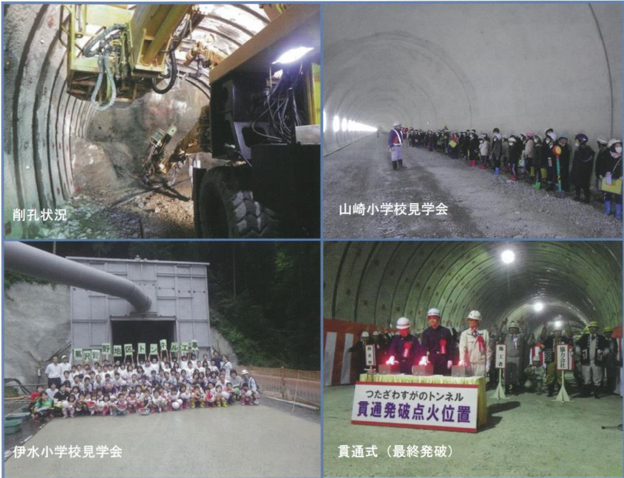
基幹農道 蔦沢菅野トンネル工事（宍粟市山崎町）【光都土地改良センター】
